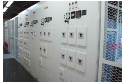
臨床研究棟電気室（高効率変圧器）
