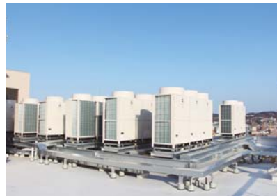
臨床研究棟屋上（屋上断熱防水、高効率空調設備）
